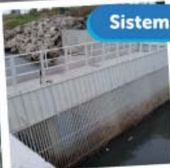
Reja de contención de sólidos
